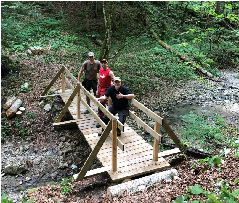
(photo, de g. à d. : Julien Grünenwald, Manfred Bühler et Fabrice Riat posent sur la passerelle terminée)
